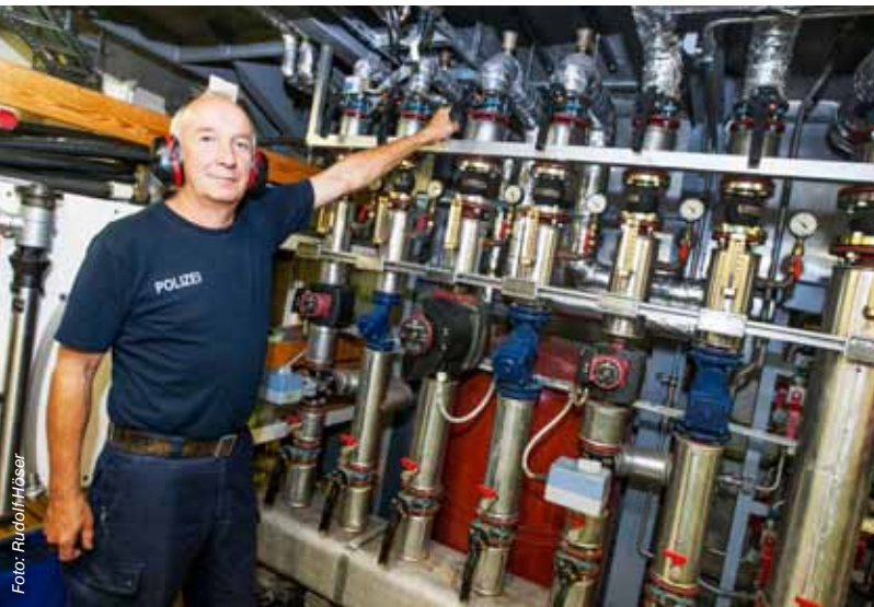
Der Leitende Maschinist Fred-Hermann Steffens überwacht die Technik im Bauch der BP 24. Die vielen Aggregate und Generatoren verursachen eine Menge Lärm und Hitze. Arbeiten ist nur mit Gehörschutz möglich.
