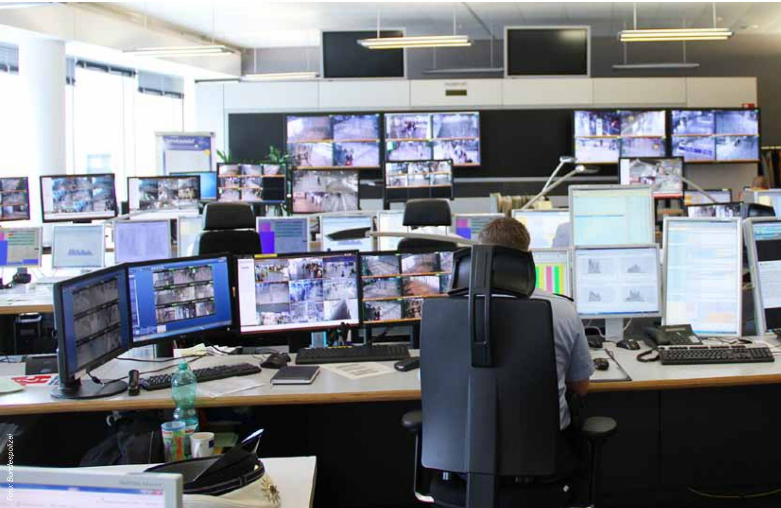
Die Integrierte Leitstelle ist eine Einrichtung des Flughafenbetreibers, in der neben dem Flughafenbetreiber alle am Passagierverkehr beteiligten Prozesspartner vertreten sind. Sie gilt als „Herz“ des Terminalbetriebs.
