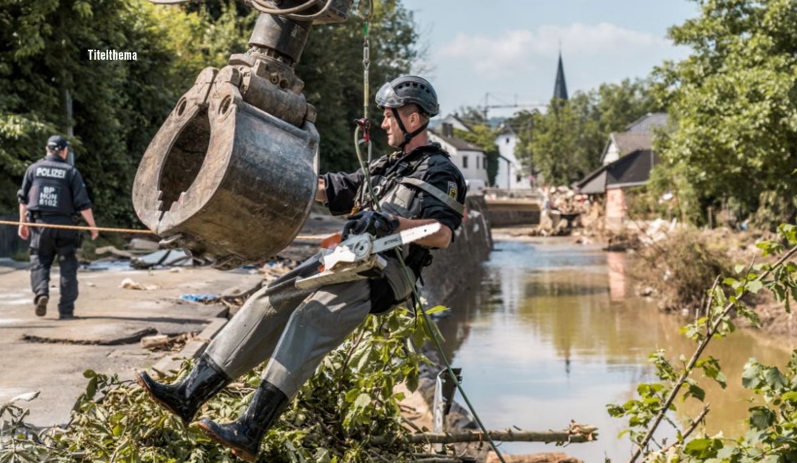
Die angeschwemmten Bäume müssen im Flussbett freigesägt und weggeräumt werden.
